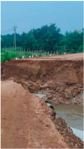
గానుగుపహాడ్ బ్రిడ్జి వద్ద తాత్కాలికంగా నిర్మించిన రోడ్డు వరద నీటికి కొట్టుకుపోయిన దృశ్యం
