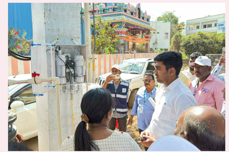
పీఠావిగూడలో ఏర్పాటుచేసిన ఆలోమేటిక్ సోలార్ ఎలక్ట్రో కోరినేటర్ ప్లాంట్ పనితీరును పరిశీలిస్తున్న జలమండలి జీ ఎం డి మాయాంక్ మిట్టల్
